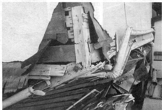
土台と柱が、はなれてしまった高級住宅の例
